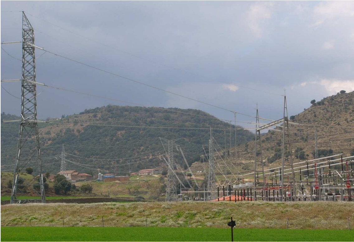
Infraestructuras de transformación de la energía eólica. Al fondo, una antigua masía y el paisaje.
